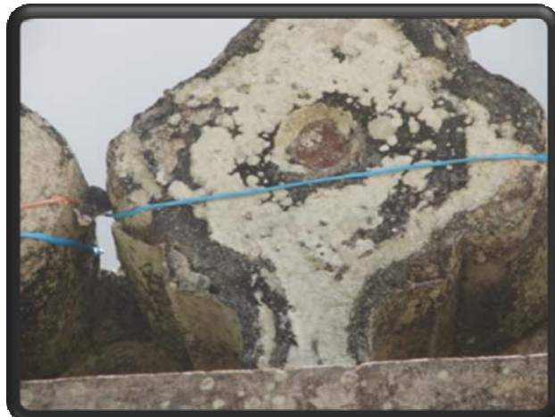
Figure 15. Acercamiento del grado de deterioro de las balastradas
