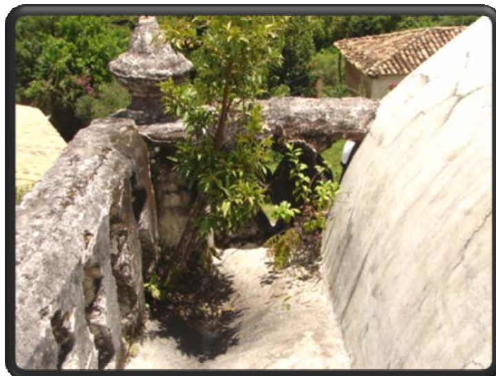
Figura 12. Canales en cúpulas y bóvedas del presbiterio, ripiados por la vegetación, estas plantas han dañado las balaustradas del parapeto o barandal
